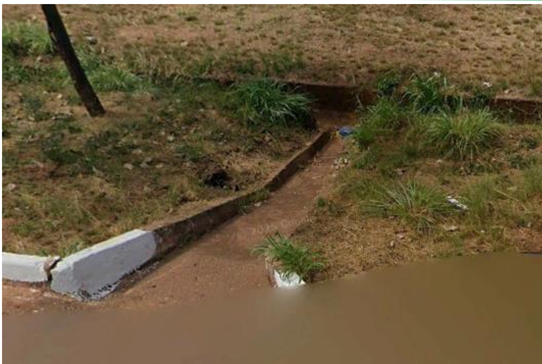
Figura 3.76: Dispositivos de drenagem (canaleta) em Nova Crixás. Fonte: Google Maps, 2025.
