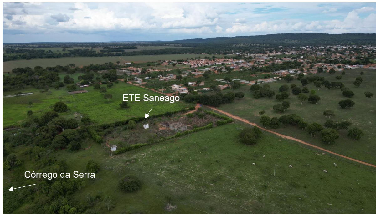
Figura 3.20: Vista da ETE da Saneago em construção próximo ao Córrego da Serra.
